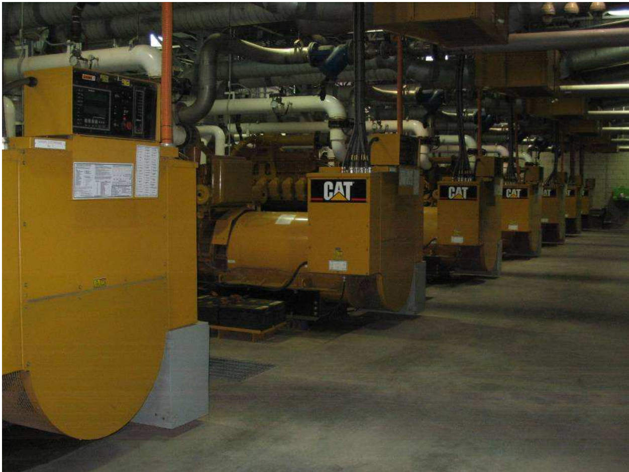
FIGURE 4 VUE DES SEPT GROUPES ÉLECTROGÈNES ALIMENTÉS AU BIOGAZ
