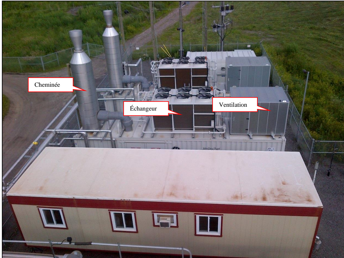
Figure 3 Centrale de cogénération
