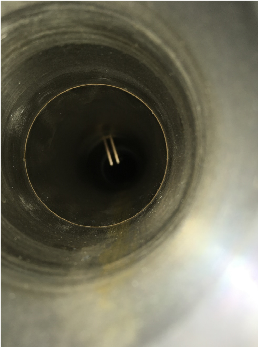
Photo du débitmètre de Val-d'Or lors de l'inspection du 6 octobre 2020
